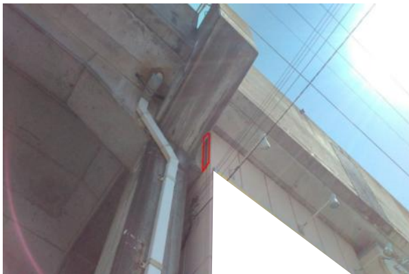
【外壁破損部位】
